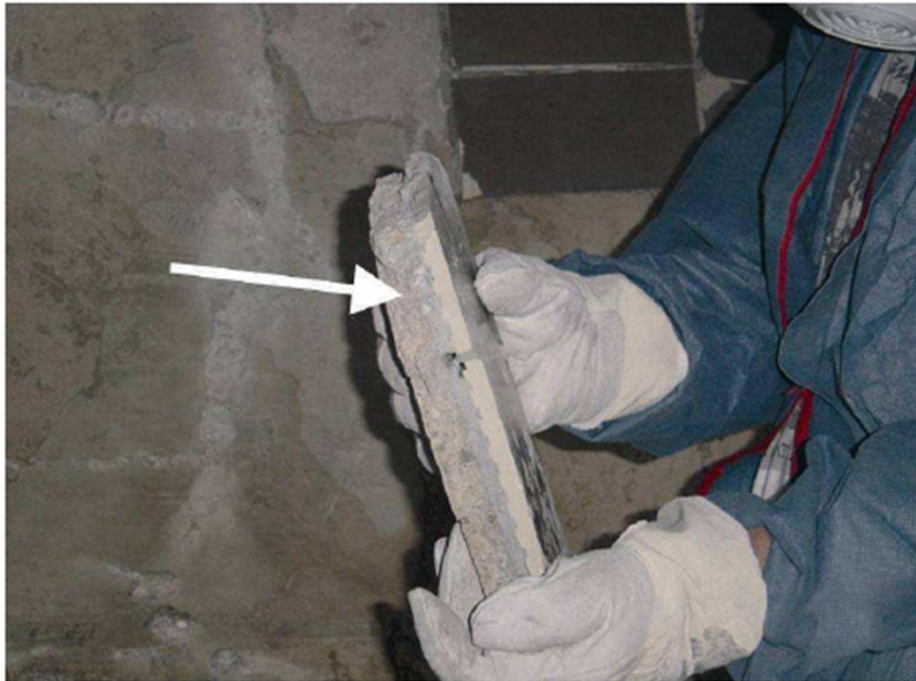
Supporti per piastrelle contenenti amianto
