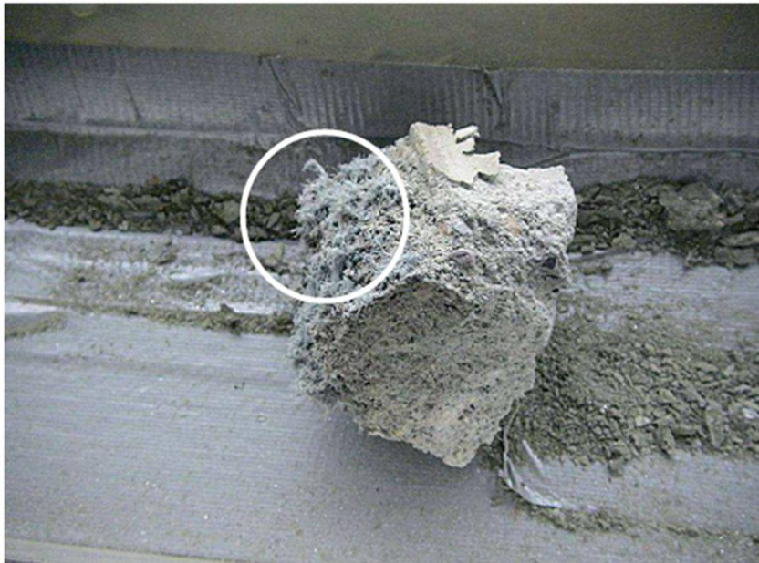
Massetto contenente amianto
